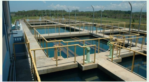
Figura 3. Estação de tratamento de água.
